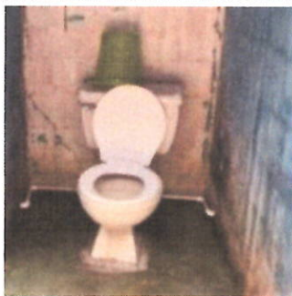
Foto 5: SERVICIOS SANITARIOS Y SUS ACCESORIOS
